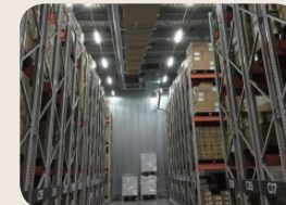
LED照明を用いた冷蔵庫内
