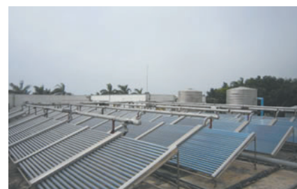
海南東洋 太陽光熱水装置
