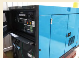
非常用発電機
