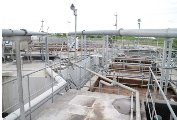
関東工場の浄化設備
