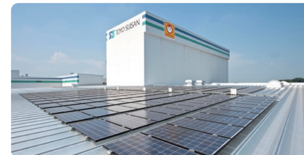
関東工場の太陽光発電パネル
