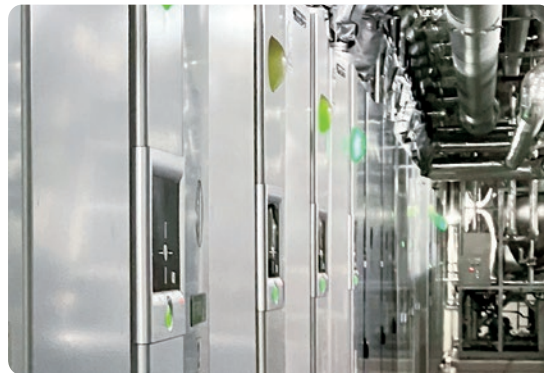
関東工場の天然ガスボイラー
