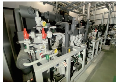
2024年に工事が完了した 城南島冷蔵庫の自然冷媒設備
