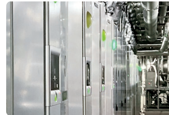
関東工場の天然ガスボイラー
