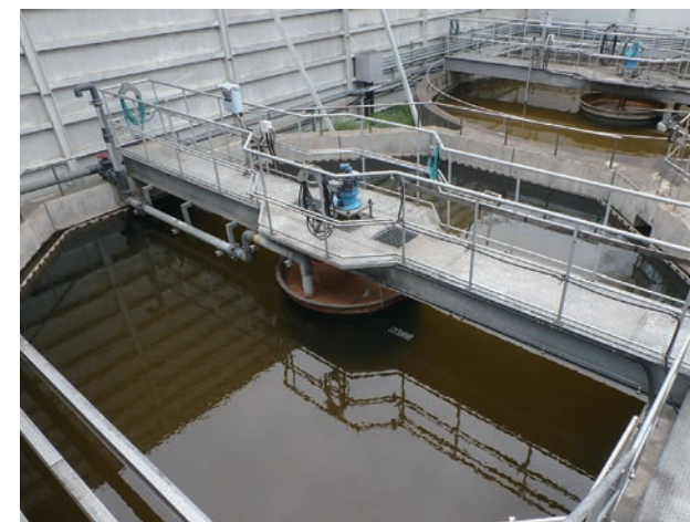
排水処理設備
