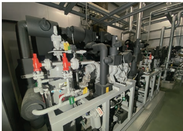
城南島冷蔵庫の自然冷媒設備(2024年度導入)
