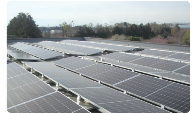
埼玉工場の太陽光パネル
