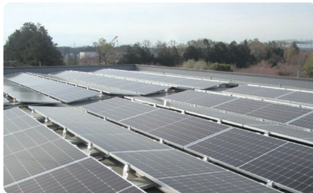
埼玉工場の太陽光パネル
